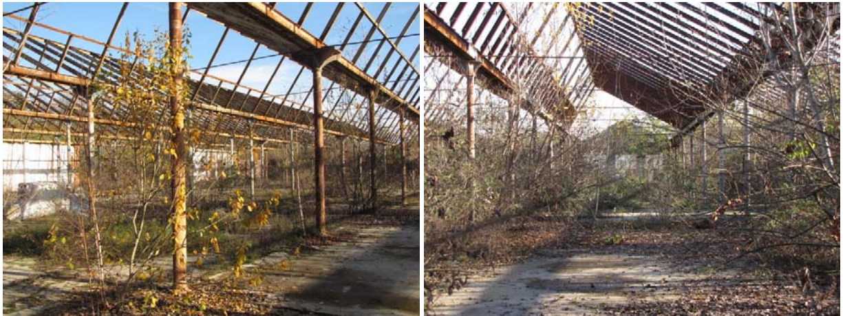
Fig. 3 e 4. Invasione del vecchio edificio della filanda da parte di specie pioniere ed esotiche.
